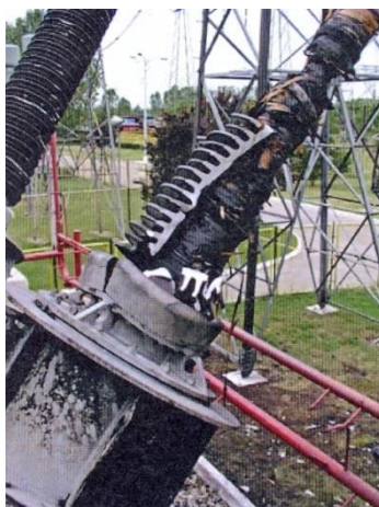
Rys. 6. Izolator na napięcie rzędu 400 kV po eksplozji [1] Fig. 6. Isolator of the range 400 kV after explosion [1]
